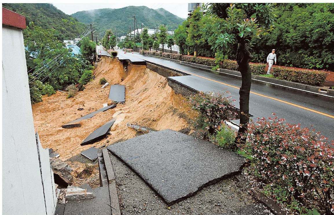
西日本豪雨で片側車線の約50メートル区間が崩落した国道430号＝7月7日、日比
