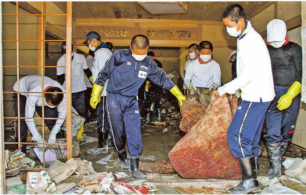
泥の染みこんだカーペットを運び出す玉野高野球部員＝19日、倉敷市真備町箭田
