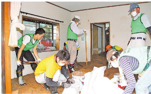
室内に流れ込んだ土砂を取り除く災害ボランティアら
